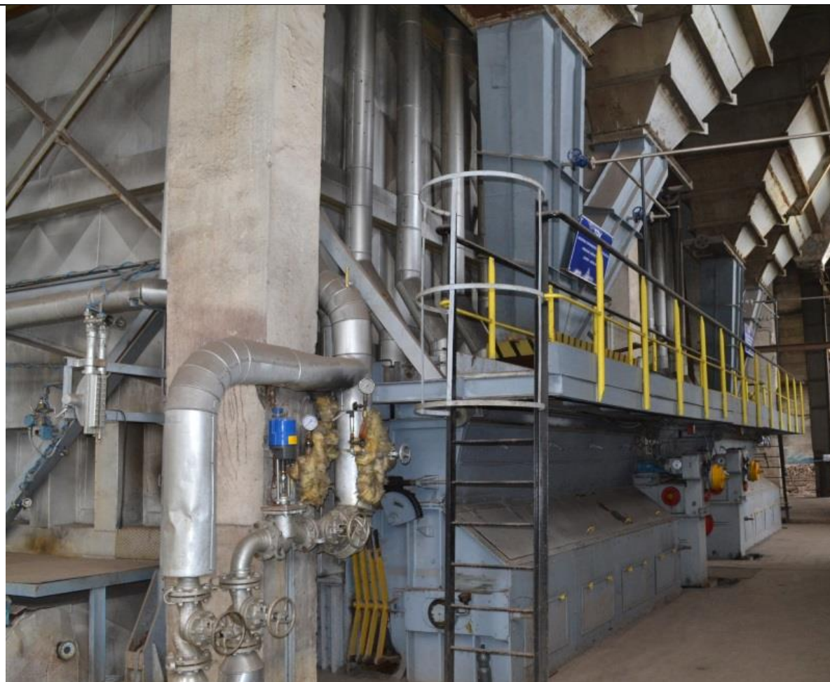
Slika 1. Kotlovi u Toplani Novi Travnik
